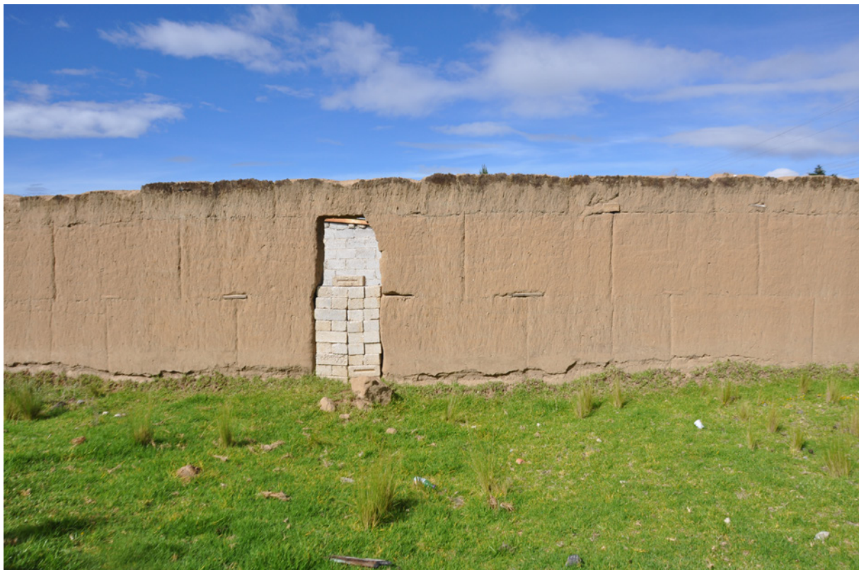
▲ Tapia fabricada con moldes. Se aprecia con claridad el contrapeo de los bloques. San Andrés Payuca, Puebla. LABPysCT. Agosto de 2014. Crédito: Fernando Zamudio Ortega.
