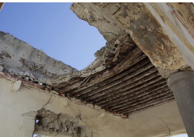
▲ Techo en ruinas donde se aprecian los materiales que componen el sistema constructivo: vigería de madera, tejamanil y terrado de rocas volcánicas con cal. LABPYSCT. Diciembre de 2014. Crédito: Diego Valadez Sáenz.
