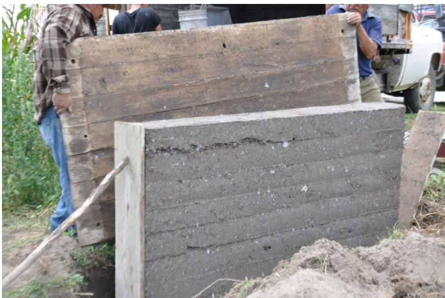
▲ Proceso de descimbrado de la tapia terminada. Tepeyahualco, Puebla. LABPYSCT. Septiembre de 2015. Crédito: Ángeles Vizcarra de los Reyes.
