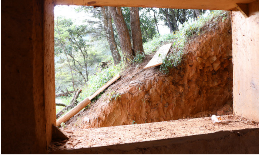
▲ Muro de tierra anegada con entrepiso de madera junto a terreno natural. LABPYSCT. Noviembre de 2014. Axayácatl Sánchez Sámano.
