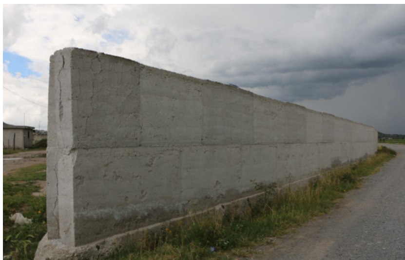
▲ En la esquina superior izquierda de la tapia se observa el fenómeno conocido como "palomeo del muro". Tepayahualco, Puebla. LABPYSCT. Septiembre de 2015. Crédito: Ángeles Vizcarra de los Reyes.
