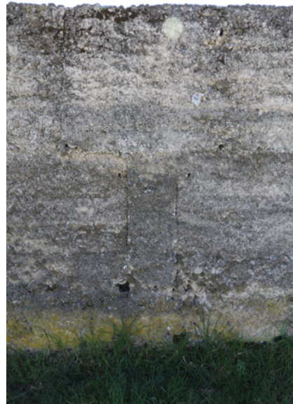
▲ Contrapeo para trabar muro perpendicular. El Fuerte de la Unión, Tepeyahualco, Puebla. LABPysCT. Diciembre de 2018. Crédito: Ángeles Vizcarra de los Reyes.
