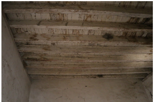
▲ Techumbre típica de la región. En el techo derruido pueden identificarse los elementos que componen la cubierta: vigas, tejamanil y terrado. Tepeyahualco, Puebla. LABPYSCT. Diciembre de 2018. Crédito: Ángeles Vizcarra de los Reyes.
