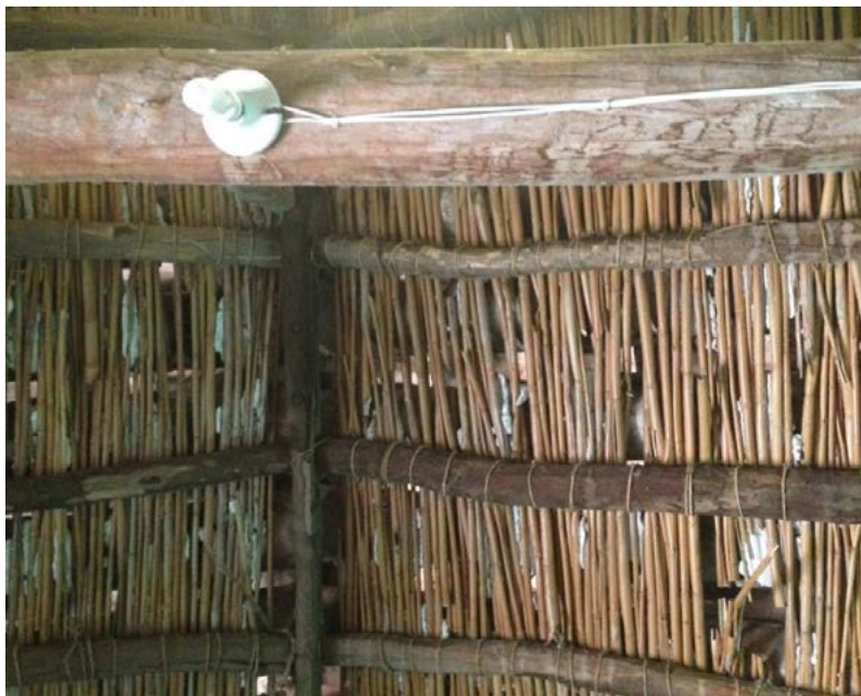
Imagen 4. Detalle del techo interior entretejido de carrizos, madera y tejas de barro. Guerrero, México. Imagen del autor.
