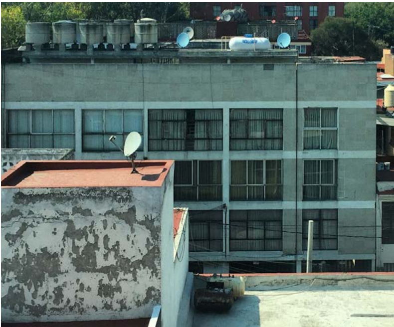
Imagen 50. La falta de mantenimiento preventivo de los materiales afecta también su aspecto estético. Fuente: Imagen del autor.
