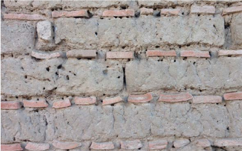
Imagen 35. Muro de adobe con pedacería de tejas en las juntas. Tepecoacuilco, Guerrero. Imagen del autor.
