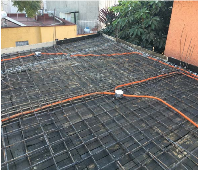
Imagen 12. Cimbra y armado de varillas de acero previo a colado de concreto de una losa maciza. Ciudad de México. Imagen del autor.
