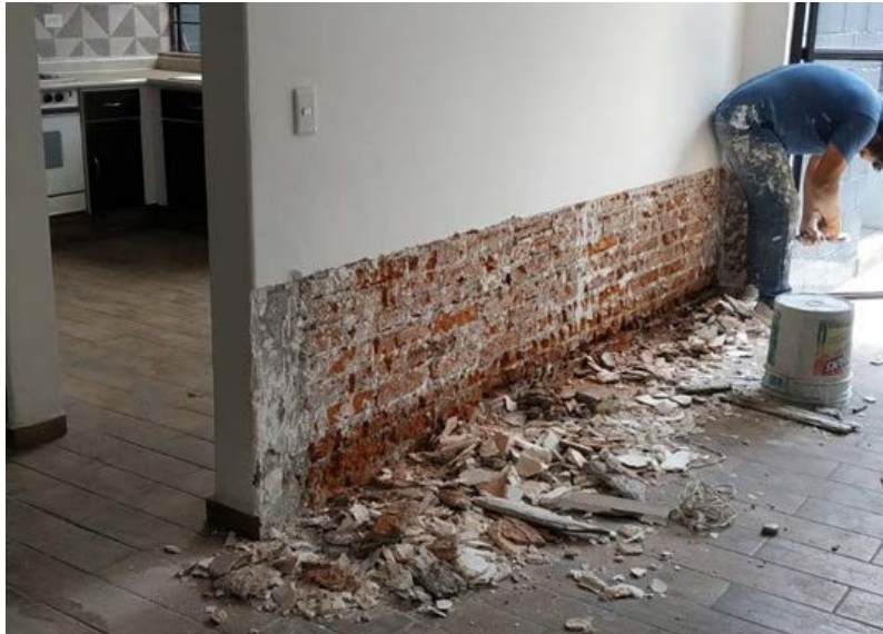
Imagen 49. Problemas de humedad en un muro de tabique rojo recocado. Nótese que las primeras hiladas de abajo hacia arriba se encuentran saturadas de agua. Fuente: Imagen del autor.
