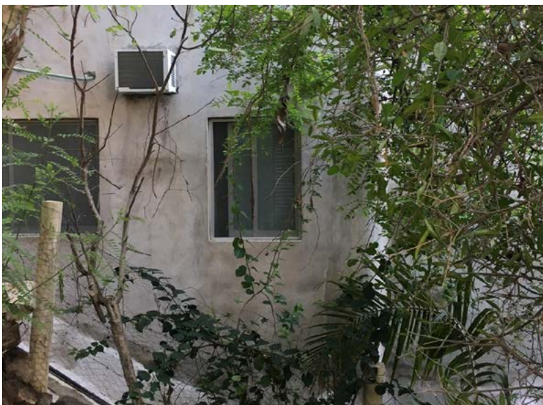
Imagen 6. Equipo de aire acondicionado para una envolvente arquitectónica con un aislamiento térmico pobre. Oaxaca, México. Imagen del autor.
