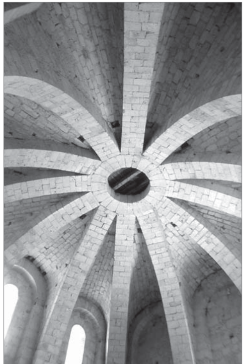
Figs. 293 y 294. Arriba. CATEDRAL DE MAINZ (Renania, Alemania, siglos XII-XIII). Entrega de los arcos diagonales y fajón de dos bóvedas de crucería cuatripartita en la semicolumna apilastrada del arco fajón. Abajo. MOISSAC. TORRE OCCIDENTAL (Francia, 1130). Cuerpo superior. Cúpula de crucería sobre arcos diagonales de sección rectangular.
