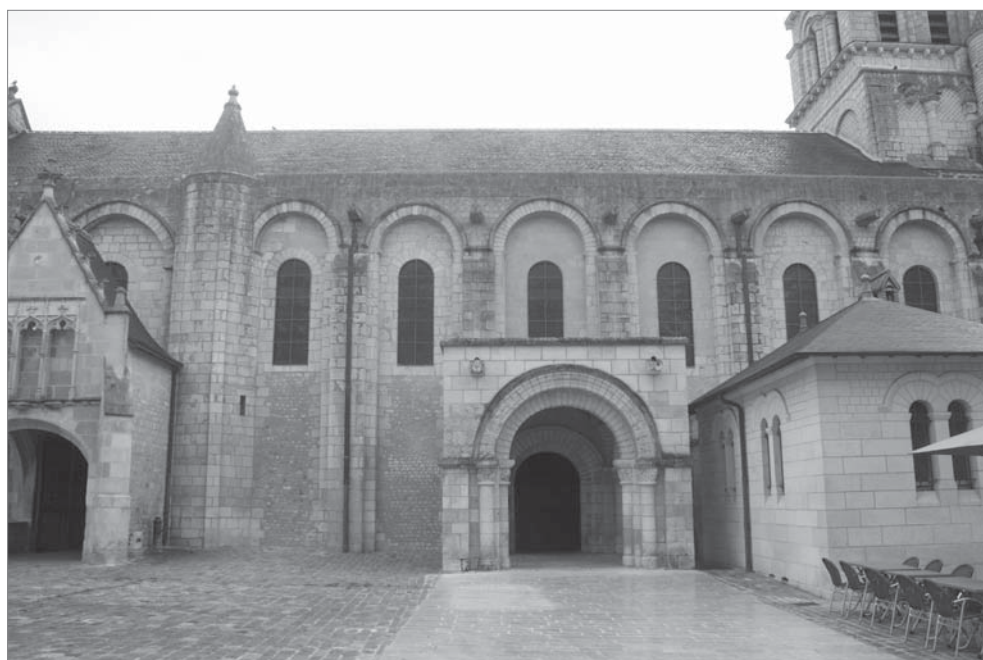
Figs. 31 y 32. Arriba. CATEDRAL DE LÉRIDA (siglo XII). Vista parcial del paramento exterior del muro sur. Ver los sillares muy afectados por la degradación y las delgadas juntas dispuestas entre ellos. Abajo. NOTRE DAME LA GRANDE (Poitiers, Francia, siglo XI-XII). Ver los contrafuertes exteriores del muro sur enlazados superiormente por arcos.
